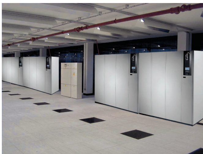
Foto 1: Model cameră de servere echipată cu Unități de Climatizare de Precizie – Leonardo-Uniflair, Italia.
